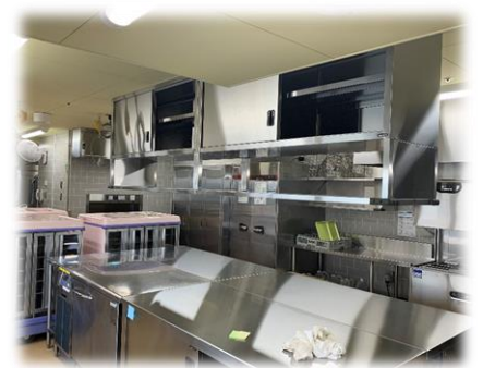
設備の最新化が進んだ厨房設備
